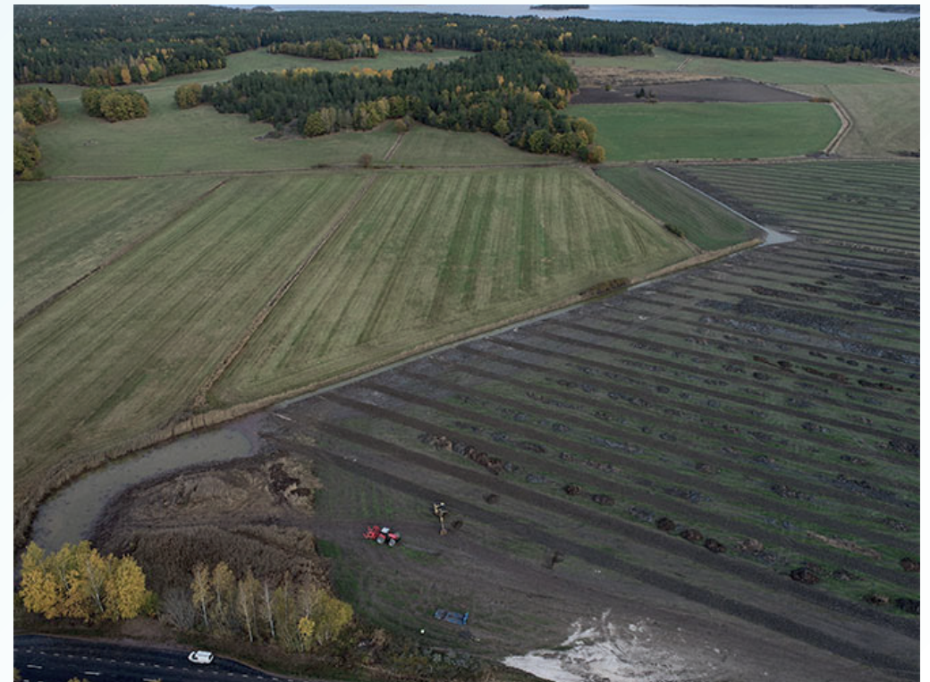
Rakenteiden kalkitus, suodatinojat ja fosforilampi
