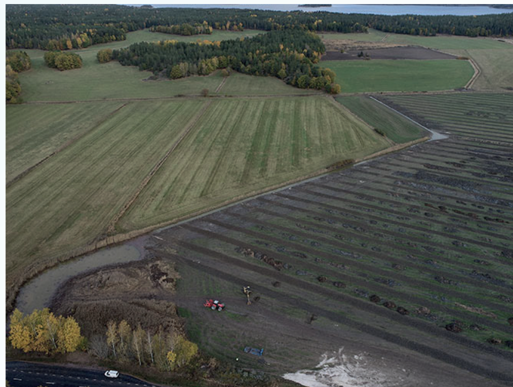
Konstrukcijų kalkinimas, filtravimo grioviai ir fosforo tvenkinys
